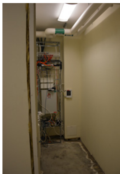
Förråd med tekniska installationer. Vlm_modkaEK-575.
