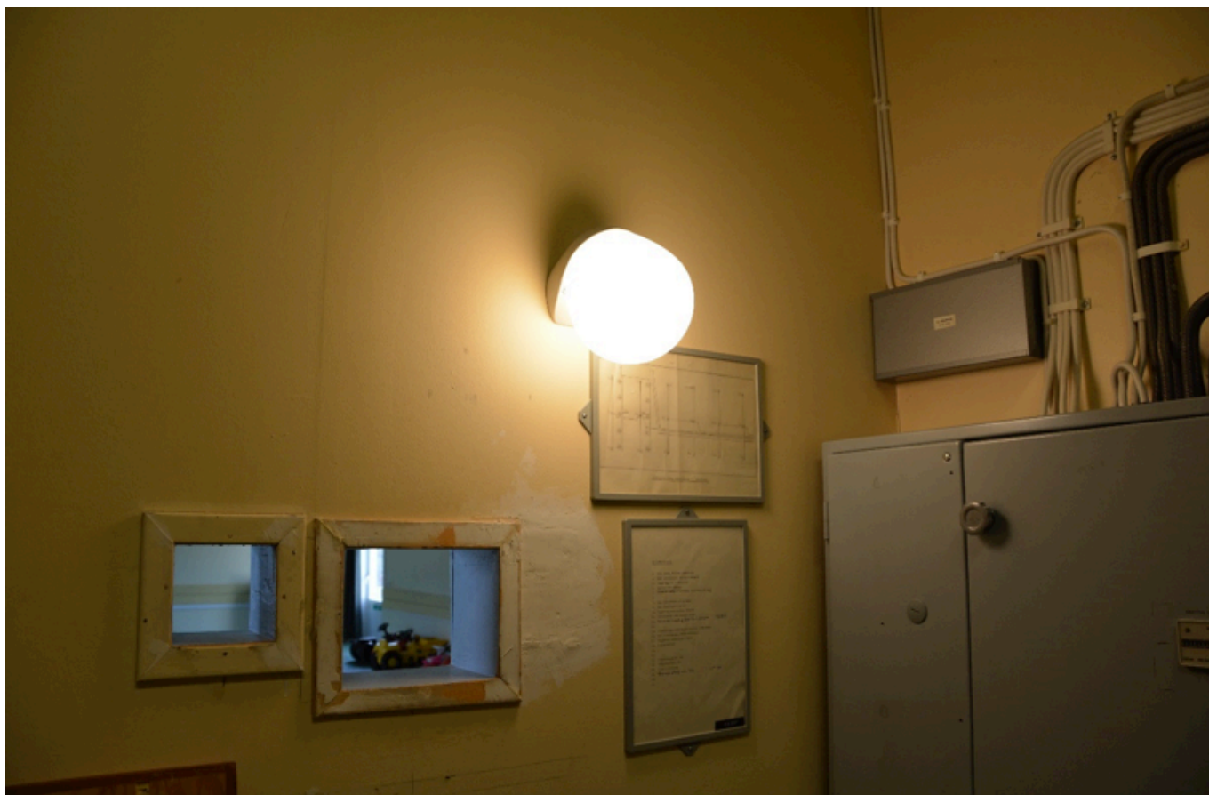
Väggfast glaskupa i opalglas i förråd 129. Vlm-modkaVB-1150.
