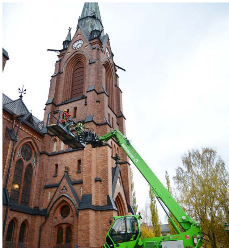
Med hjälp av kyrkoantikvarisk ersättning renoveras fasaden på Umeå stads kyrka. Foto: Lina Eriksson/ Umeå pastorat.
