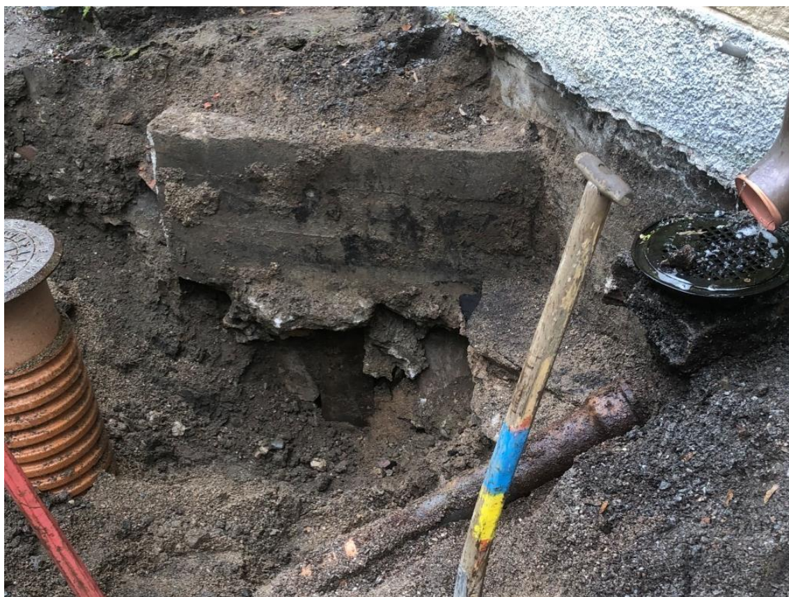
Provgrop utanför Sakristians norrvägg i juni 2022. I bildens mitt syns betongfundament från arbetet 1936 och under betongen en rostig stålpåle. I betongfundamentet finns ingjuten en stålbalk tvärs genom ytterväggen med upplag på en stålpåle på insidan.
