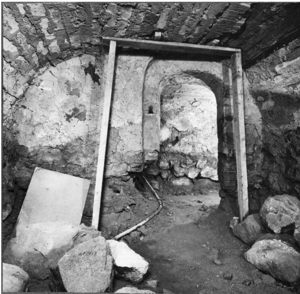
Ett av de valvslagna rummen i den gamla källaren under sakristian som ersattes med en nybyggnad 1956.
