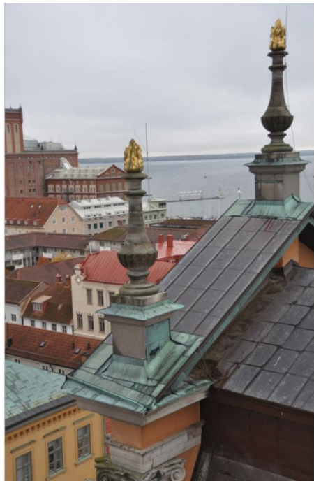
Foto: Inspektion av Domkyrkans tak inför kommande års underhållsarbeten, Per-Ola Hall, fastighetschef
