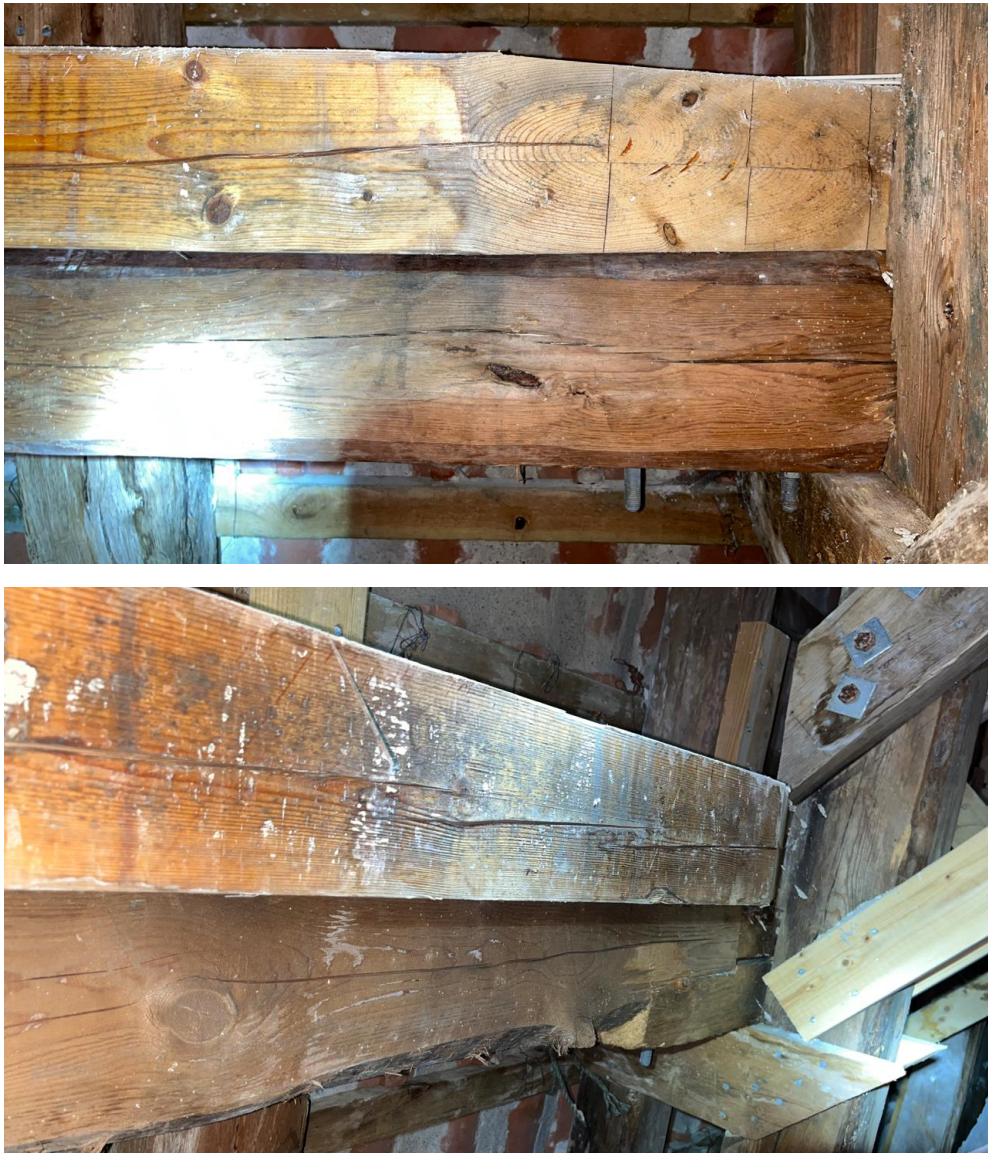
Figur E1. Exempel på sprickor i limträbalkar och åsar som kan tyda på överbelastning.
