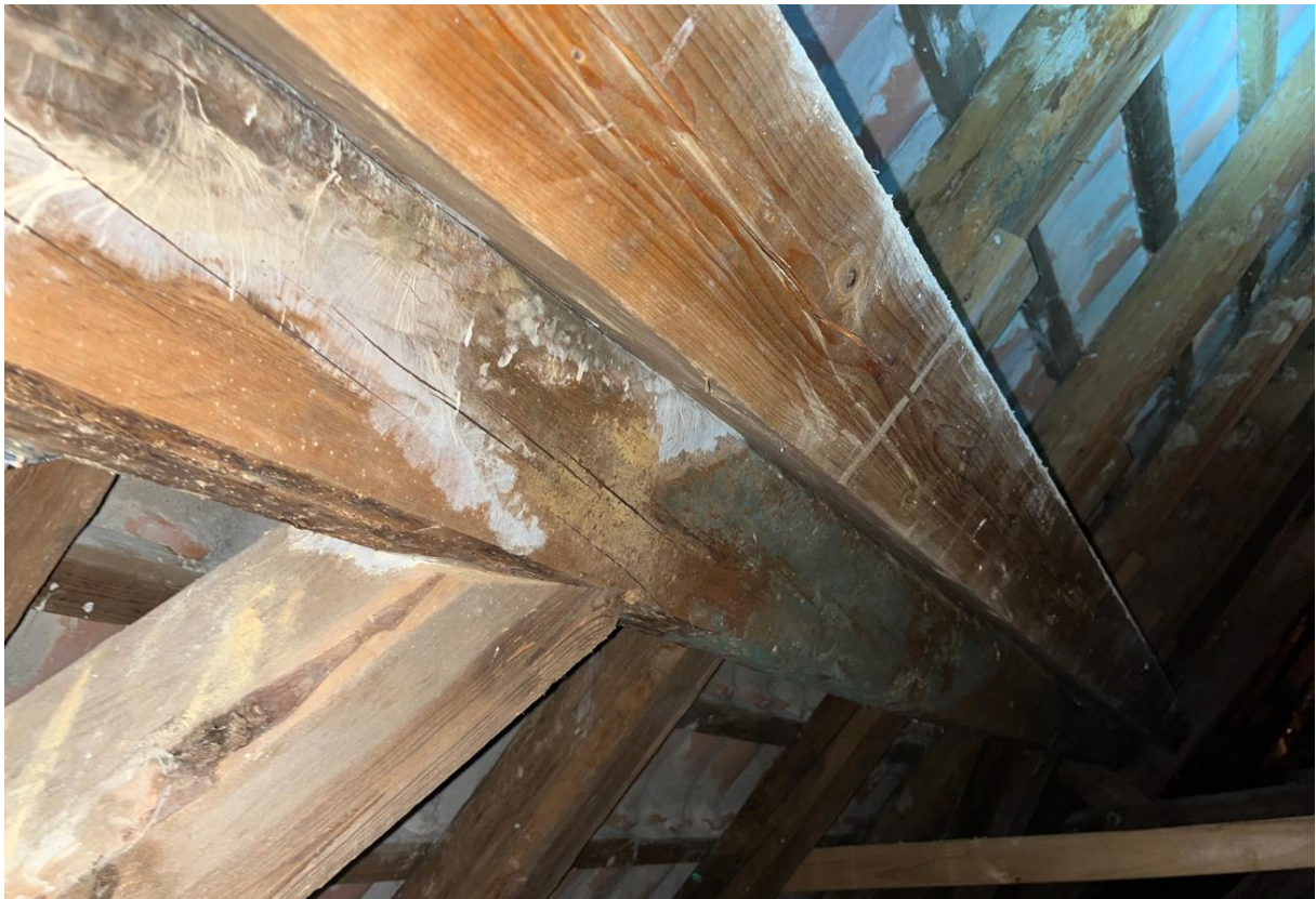
Figur E2. Exempel på sprickor i limträbalkar och åsar som kan tyda på överbelastning. Angrepp av rötsvamp, troligen Källarsvamp enligt analys.
