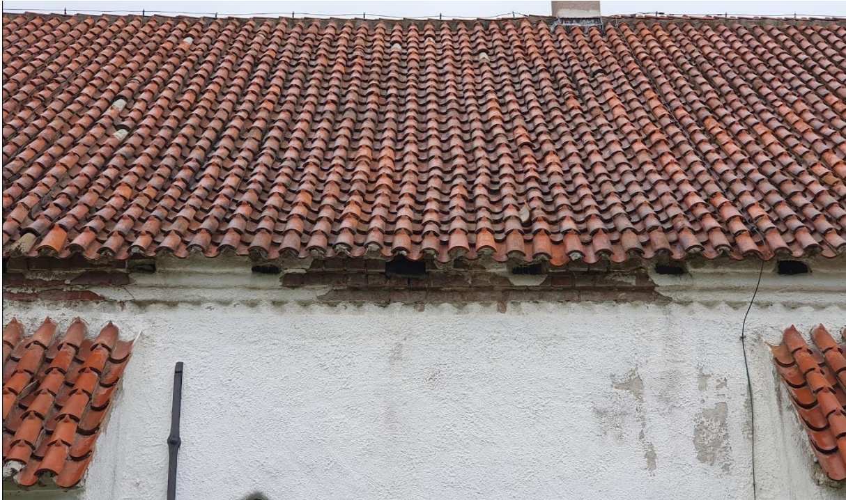
Del av långhusets södra fasad med puts-skador i augusti 2023.
