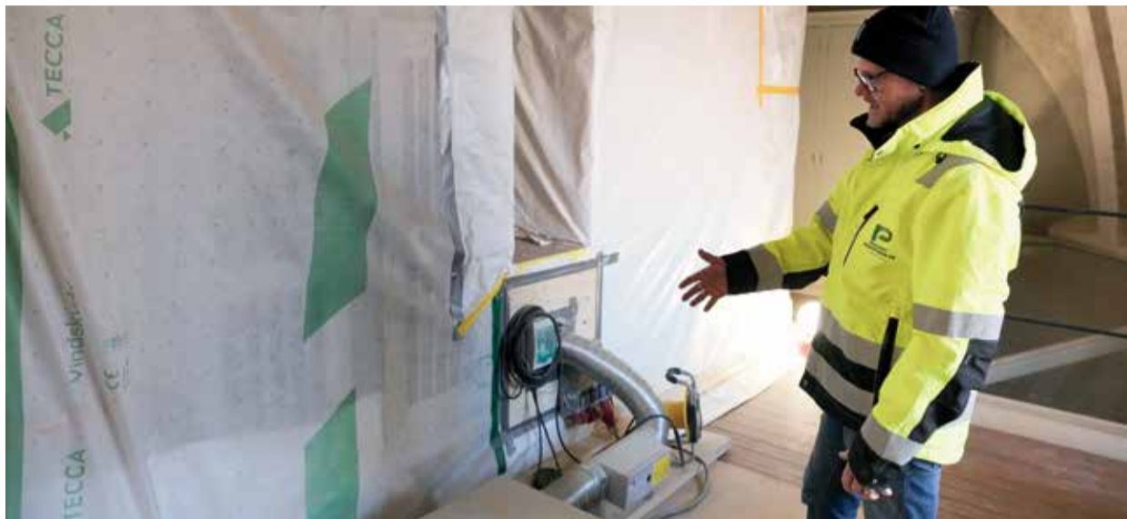
Det tar lång tid att täcka alla föremål i kyrkan på rätt sätt. Här visar Conny Lundell orgeln som är känslig för både damm, fukt och kyla. Nu finns en fläkt för att hålla luften i cirkulation och varje dag mäter Conny luftfuktigheten så att orgeln inte skadas.
