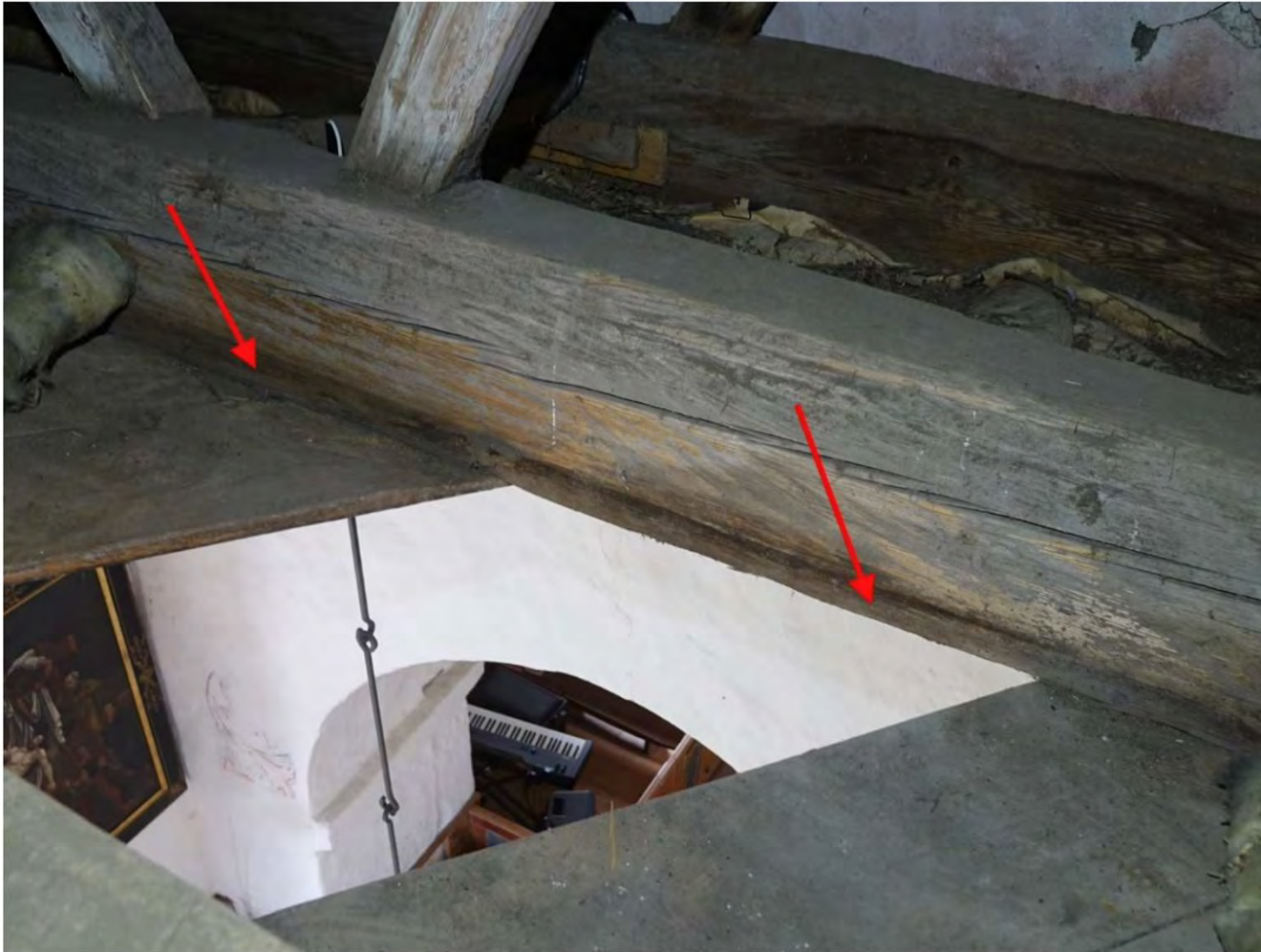
Figur 8. Pilarna visar exempel på området på bindbjälkarnas nedre delar som varit täckta av isoleringen och blivit angripna och delvis rötskadade. Omfattningen av detta varierar men samtliga bindbjälkar i koret utom nr 3 och 4 bedöms vara påverkade. I långhuset förekommer också skador men de är inte lika omfattande.
