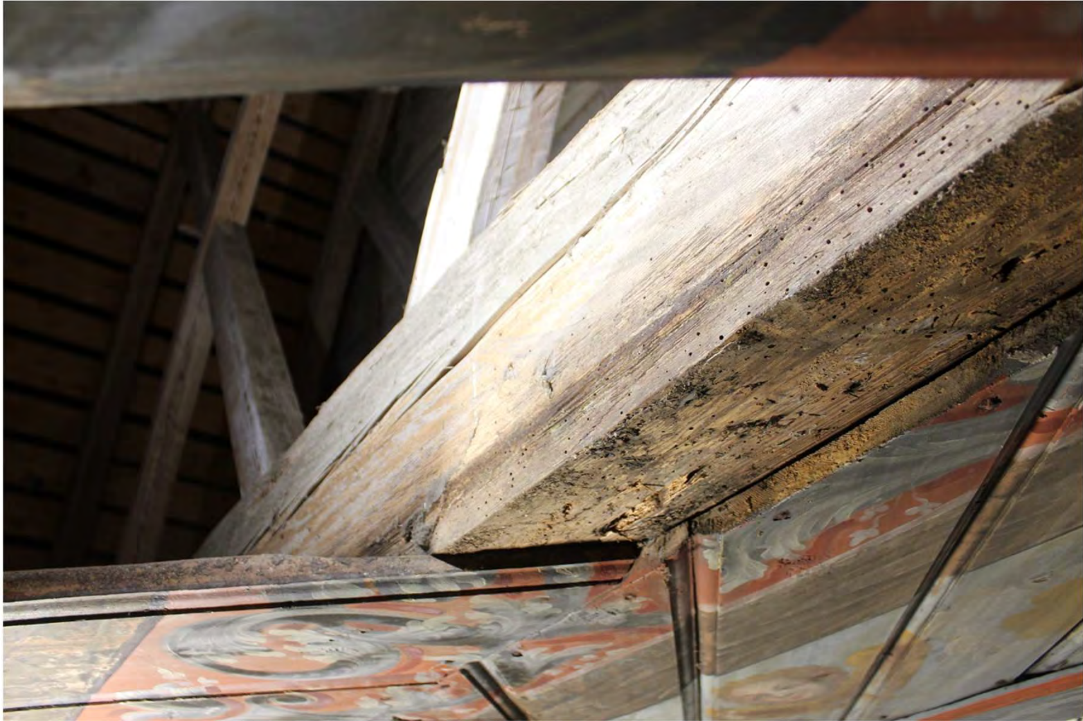
Figur 9. Bindbjälke nr 2 i koret. Materialet på undersidan är drabbat av insektsangrepp och röta upp 3-4 cm vilket påverkar infästningen av takbrädorna. I övrigt bedöms bindbjälken vara i gott skick.
