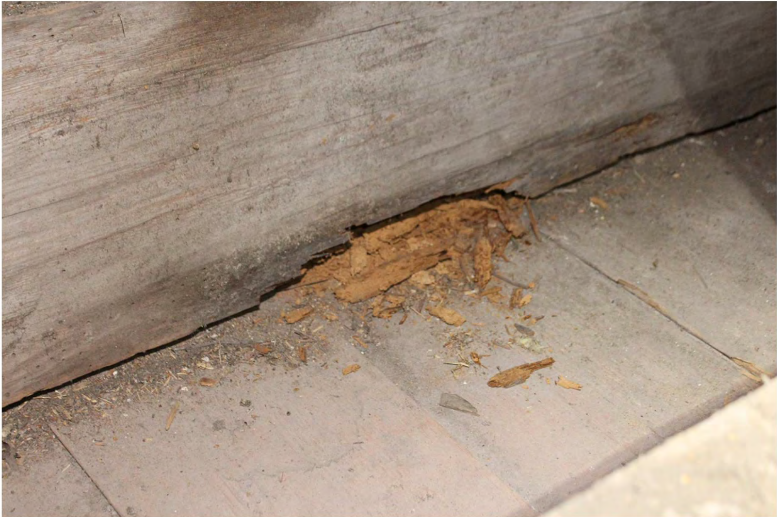
Figur 10. Exempel på rötskada på bindbjälke över långhuset. Bindbjälke nr 9.
