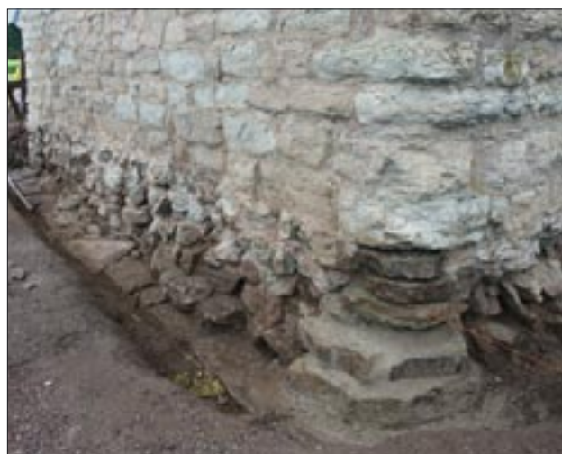
Fig 43. Stenkilska gravkoret, södra fasaden, med frilagd grundmur mot nordväst. Lägg märke till sula av kalkstenar samt därovan bortbilade skift (U4719:32).
