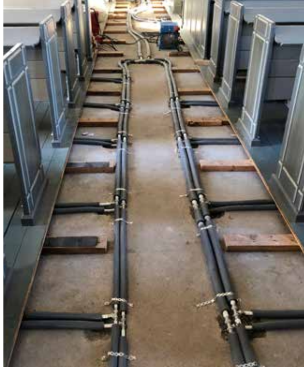
2022 fick Färingtofta kyrka ett nytt värmesystem kopplat till jordvärme.
