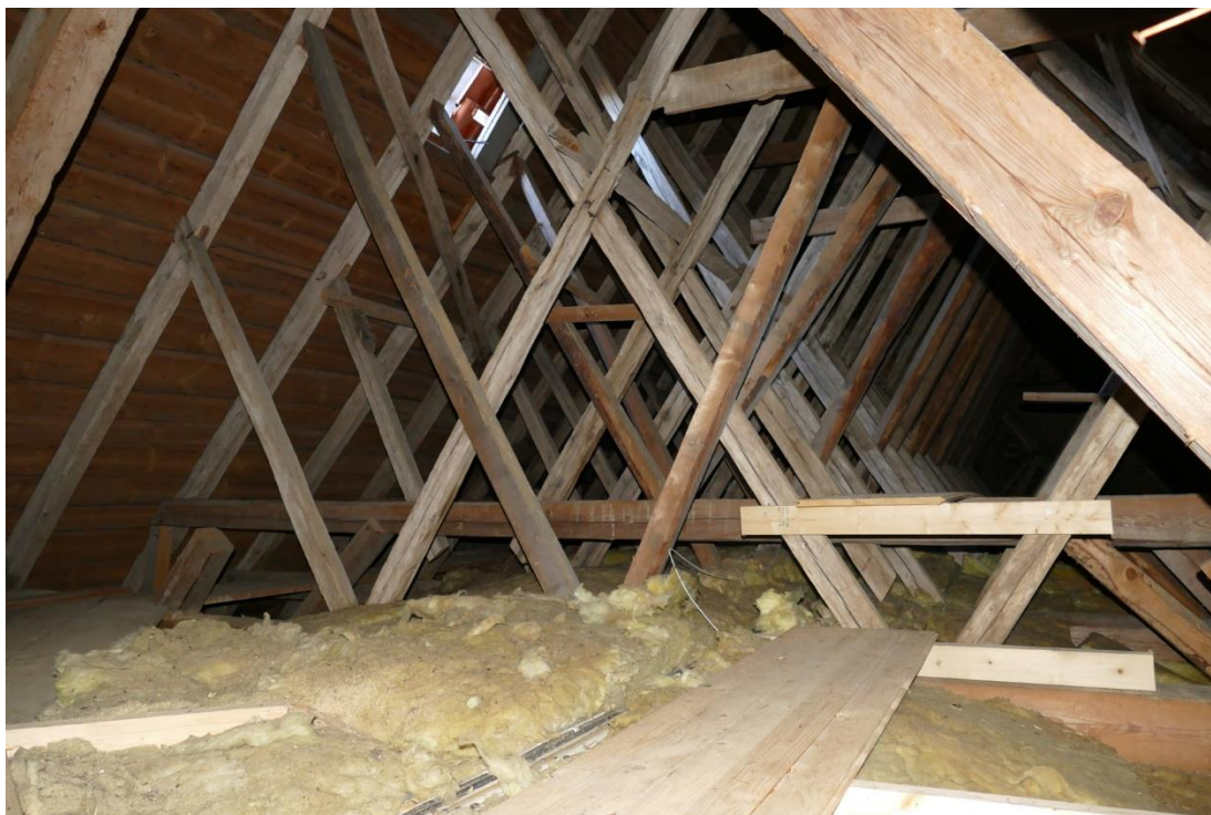
Delar av långhusets och korets taklag är dendrokronologiskt daterat till 1400-tal. De krysslagda sparrarna av ek är av stort byggnads- och hantverks-historiskt värde och en del av kyrkans äldsta historia.
