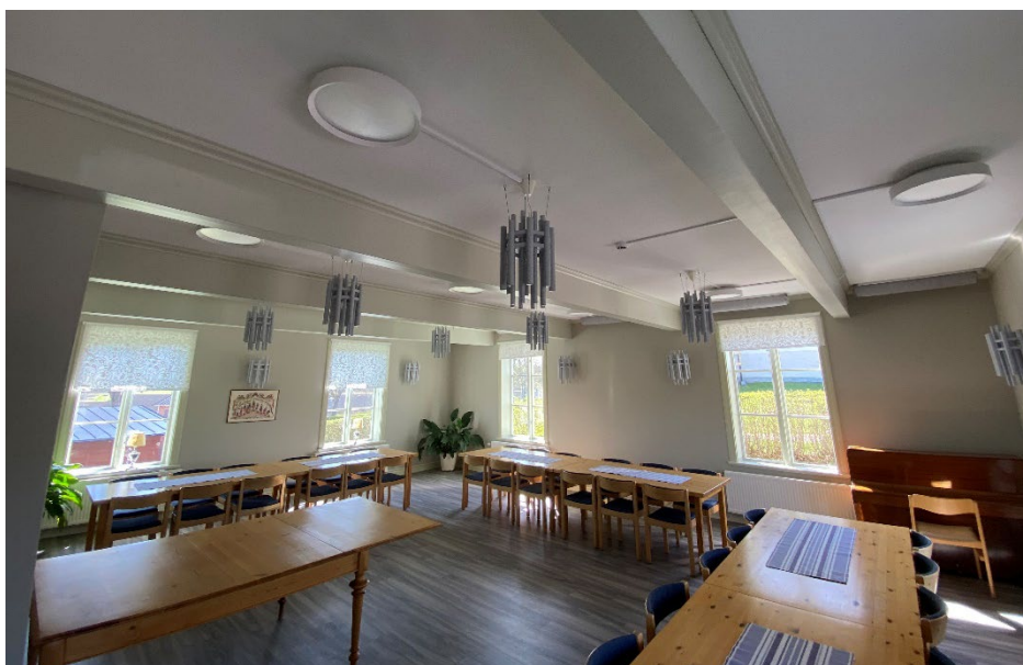
Ny allmänbelysning har installerats i stora salen.
