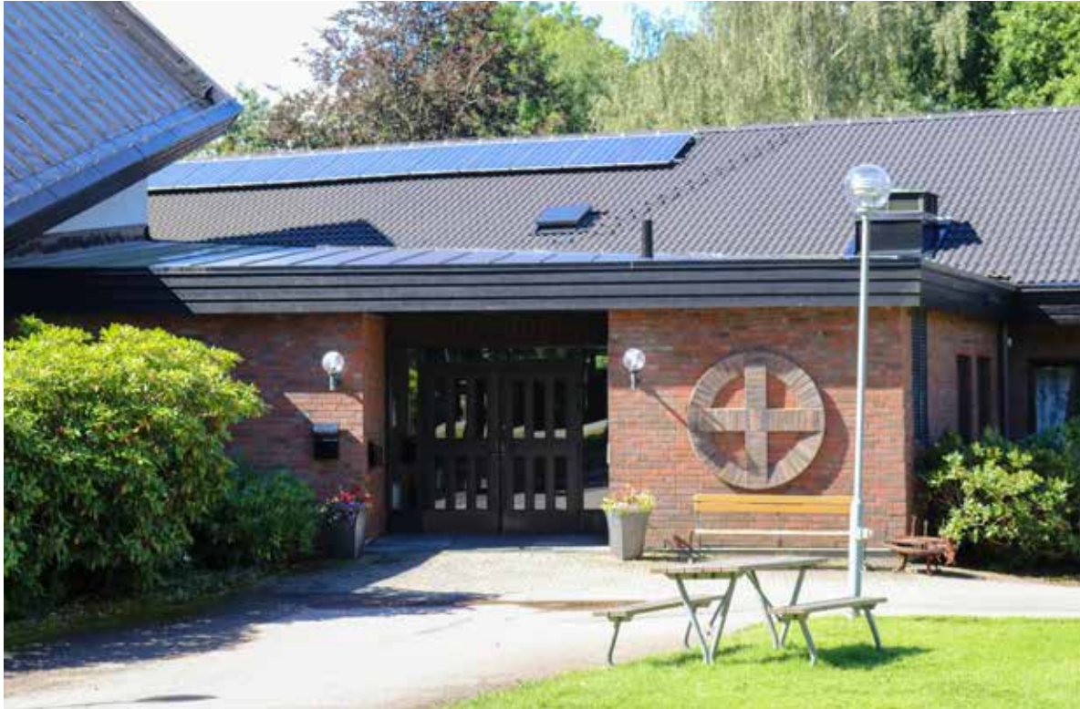
Vargöns kyrka i Trollhättan har 157 solpaneler på taket. Dessa ger nästan 40 000 kilowattimmar elektricitet per år.
